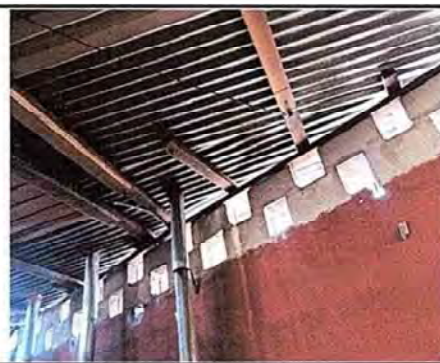
Foto 6: entechado en mal estado
