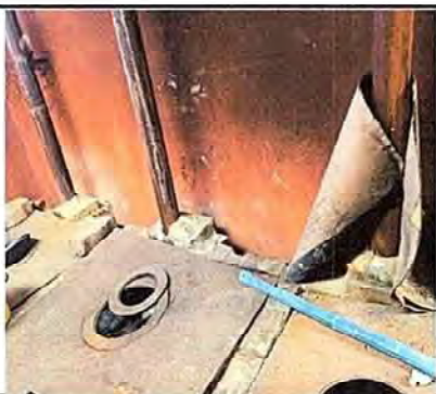
Foto 5: Las 3 chimeneas están en mal estado
